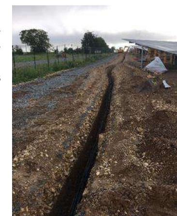
Tranchée pour la pose des câbles enterrés entre les locaux techniques – source : LUXEL
